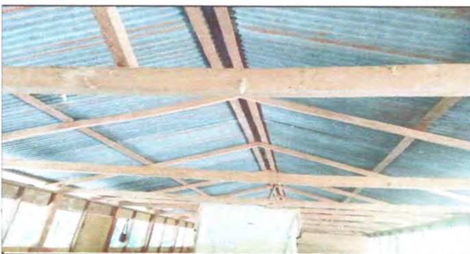
Foto 5: Las llaminas esta deterioradas
